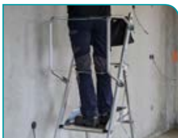
Protection de l'opérateur par garde-corps et chaînettes.
