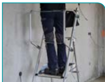
Protection de l'opérateur par garde-corps et chaînettes.
